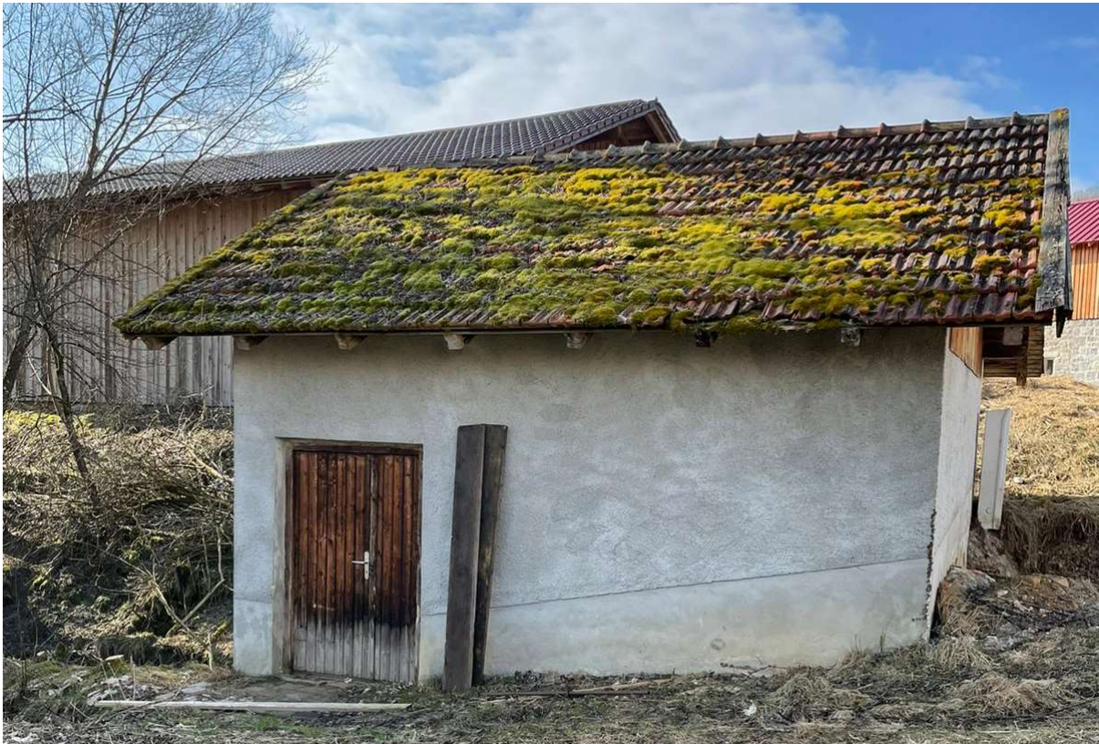
Krafthaus WKA Sägmühle (Foto: Antragssteller)
